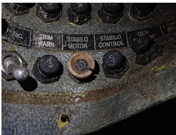
Foto 44: particolare del pannello dei circuit breaker con interruttori da 10 AMP dell'attuatore del trim dello stabilizzatore o pitch trim. la parte posteriore era completamente mancante e pertanto gli interruttori erano liberi di muoversi e pertanto privi di valenza investigativa.
