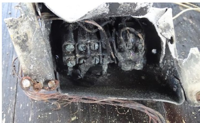
Foto 42: particolare della parte posteriore del pannello che evidenzia i danni conseguenti l'impatto e l'incendio.
